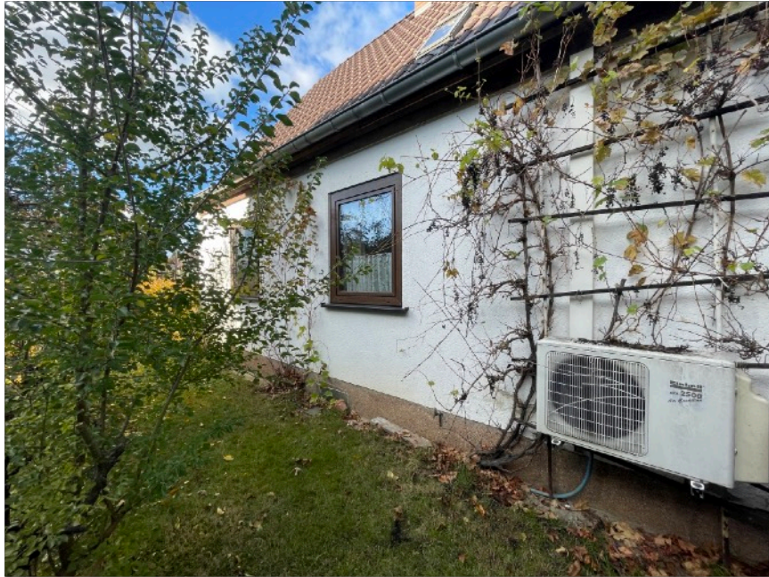
Seitlicher Grundstücksbereich mit verbautem Klimagerät
